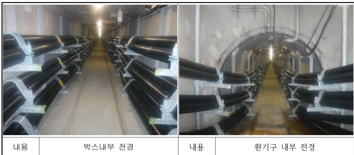
[사진 9.1] 문산SS인출 전력구 현황
