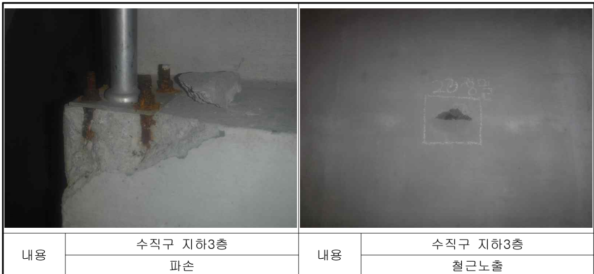
【사진 9.3】 문산SS인출 전력구 환기구 및 수직구 주요 손상
